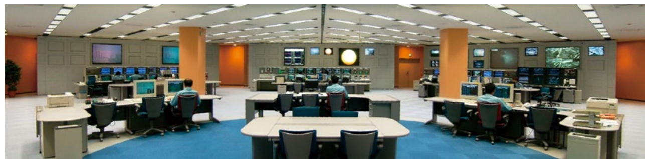
統合生産センター (Integrated Production Center: IPC) コントロールルーム (網干工場/兵庫県)
